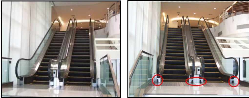
รูปแสดงการติดตั้งอุปกรณ์ตรวจจับการเคลื่อนไหวสำหรับบันไดเลื่อนก่อนและหลังการปรับปรุง
