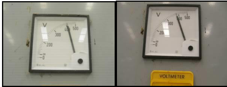
รูปแสดงการปรับแรงดันหม้อแปลงไฟฟ้าและเครื่องวัดแรงดันไฟฟ้าก่อนและหลังการปรับปรุง
