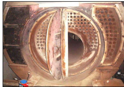
รูปแสดงสภาพเขม่าจับบริเวณท่อไฟของหม้อไอน้ำ หลังก่อนการปรับปรุง
