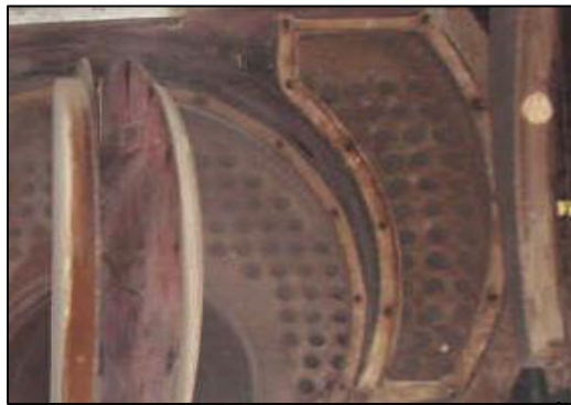
รูปแสดงสภาพเขม่าจับบริเวณท่อไฟของหม้อไอน้ำ ในปริมาณมากก่อนการปรับปรุง
