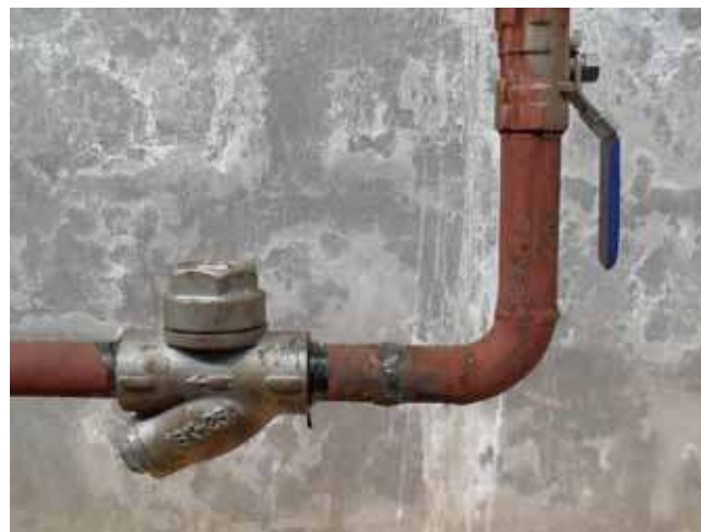
รูปแสดงอุปกรณ์ดักไอน้ำ หลังดำเนินการปรับปรุงและการตรวจวัด
