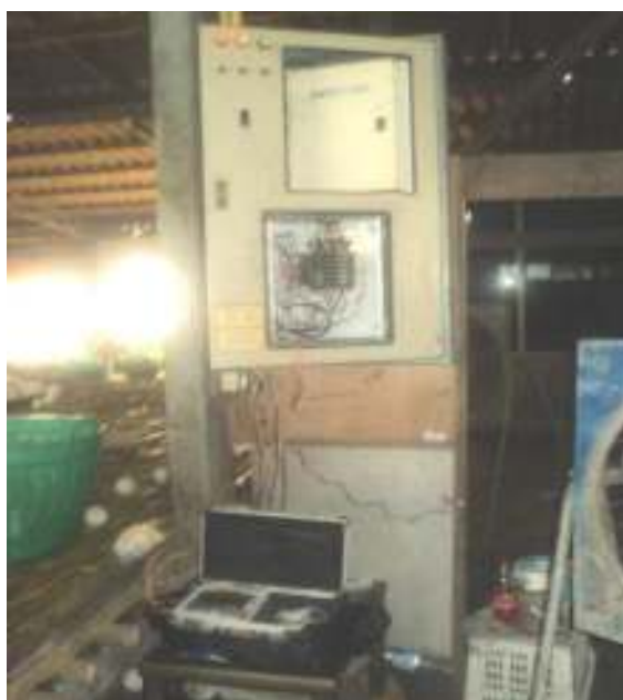
รูปการตรวจวัดระบบไฟฟ้าที่ตู้จ่ายไฟฟ้า
