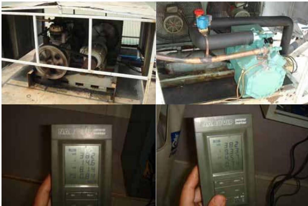
รูปแสดงเครื่องอัดน้ำยาทำความเย็นที่ใช้กับห้องเย็นและการตรวจวัดทางไฟฟ้า
