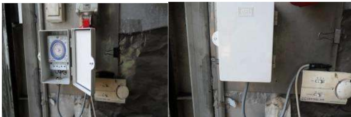
รูปการติดตั้ง อุปกรณ์ควบคุมการเปิด - ปิด เครื่องปรับอากาศ หลังปรับปรุง
