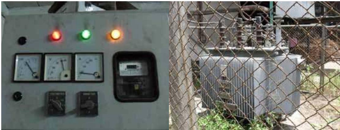
รูปแรงดันไฟฟ้า ก่อนปรับปรุง
