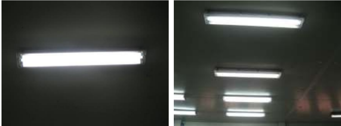
รูประบบแสงสว่างที่มีการเปิดใช้งานในโรงงาน (โคม + แผ่น สะท้อนแสง 1:1)
