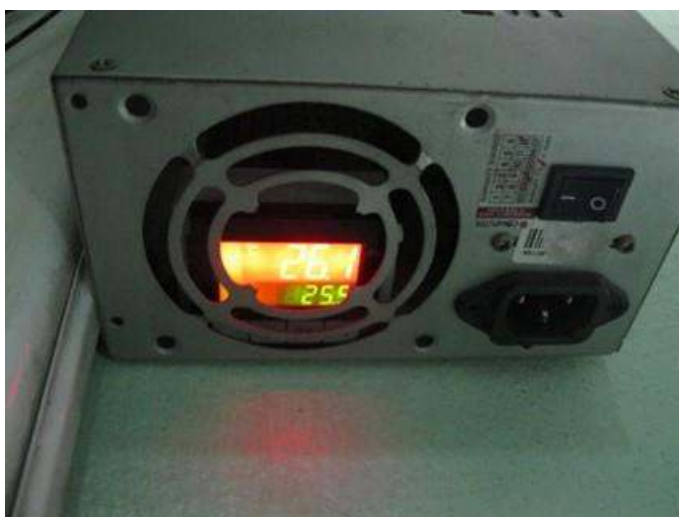
รูปแสดงอุณหภูมิของระบบทำความเย็น Package Unit
