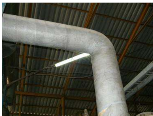
รูปแสดงการหุ้มฉนวนท่อนำสารทำความเย็น หลังการปรับปรุง
