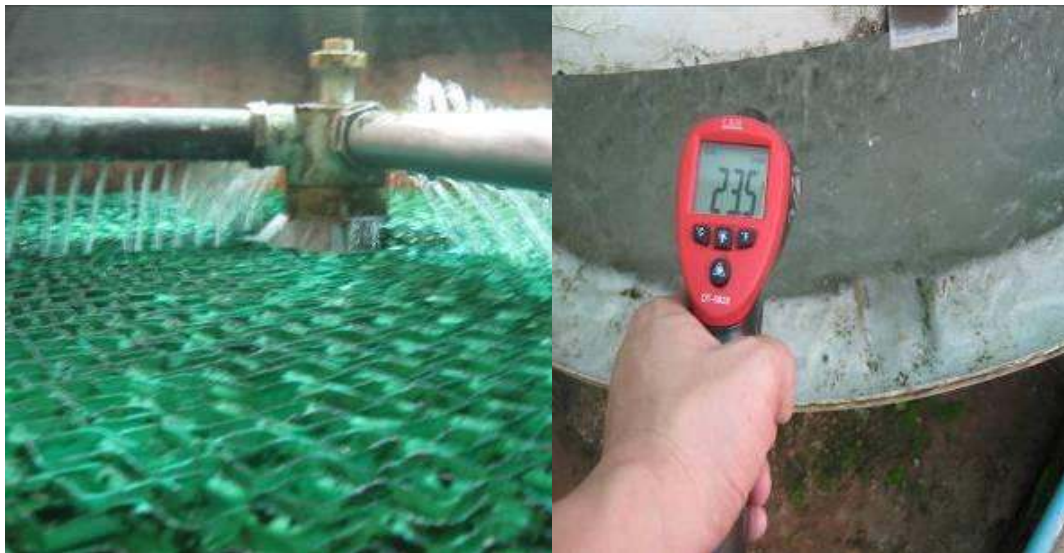
รูปแสดงการตรวจเช็คคุณสมบัติของน้ำหล่อเย็นและการทำความสะอาด (หลังการปรับปรุง)
