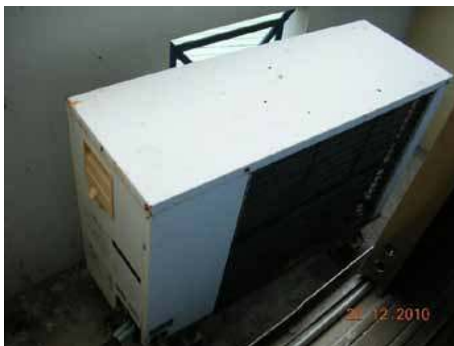
รูปแสดงเครื่องปรับอากาศหลังการปรับปรุง
