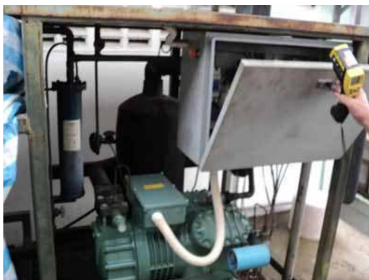
รูป Chiller ขนาด 11 kW
