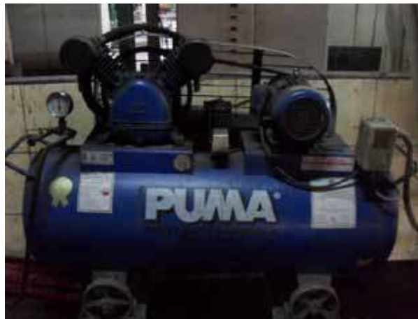
รูปแสดงเครื่องอัดอากาศที่ใช้ในโรงงาน
