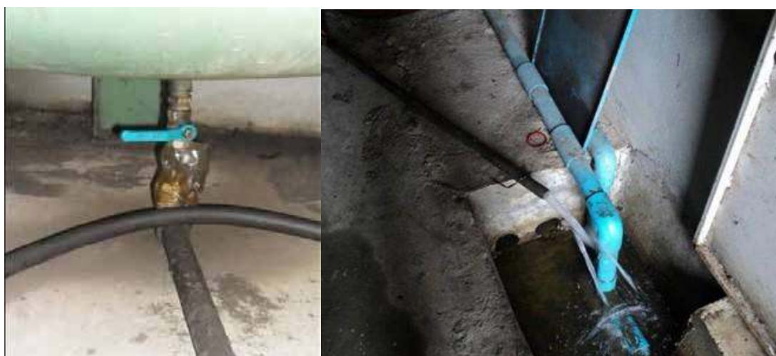
รูประบบระบายน้ำของอากาศอัด ก่อนปรับปรุง
