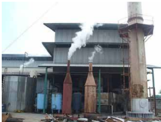
รูปแสดงการใช้งานหม้อไอน้ำของทางโรงงาน
