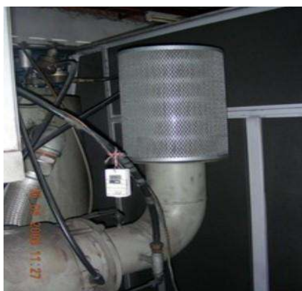
รูปแสดงการใช้งานของ Filter Air Compressor หลังปรับปรุง
