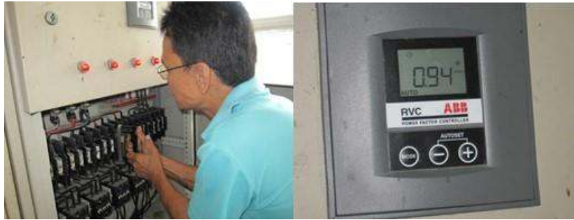
รูปแสดงการเปลี่ยนฟิวส์ของตัวเก็บประจุและค่าตัวประกอบกำลังไฟฟ้า หลังการปรับปรุง
