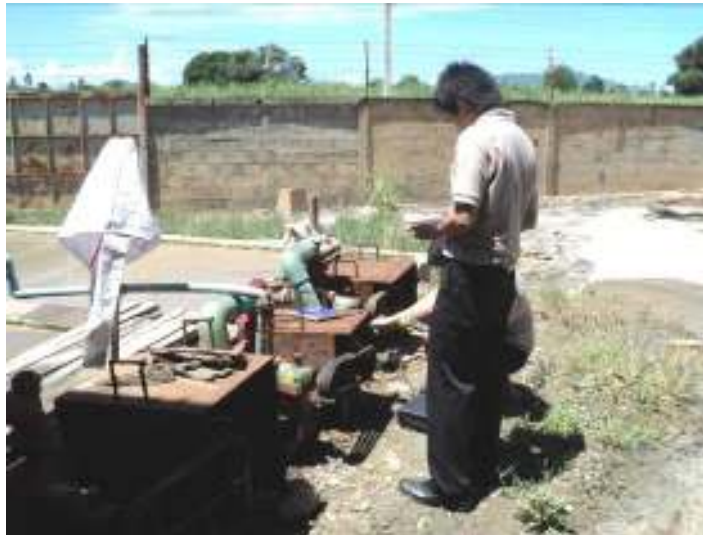
รูปการใช้งานของสายพานหย่อนที่ชุดมอเตอร์กำลัง
