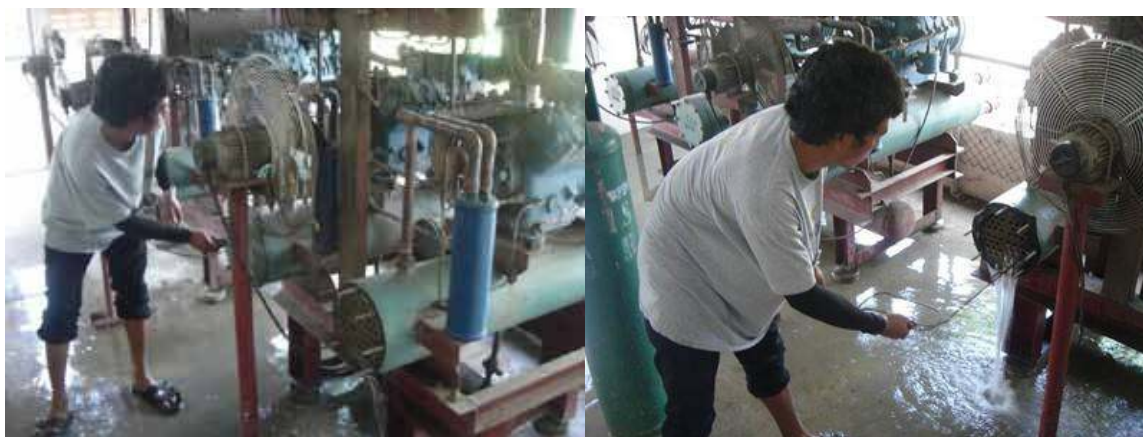
รูปแสดงการทำความสะอาดคอนเดนเซอร์ของชุดทำความเย็น
