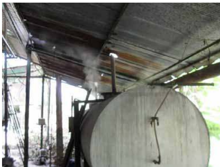
รูปแสดงบริเวณที่มีการรั่วไหลของน้ำคอนเดนเสท (ก่อนการปรับปรุง)
