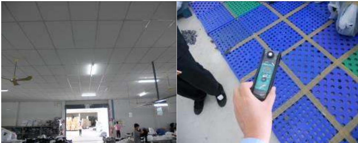
รูปแสดงหลอดไฟฟ้าแสงสว่างและการตรวจวัดค่าความส่องสว่างในโรงงาน ก่อนปรับปรุง
