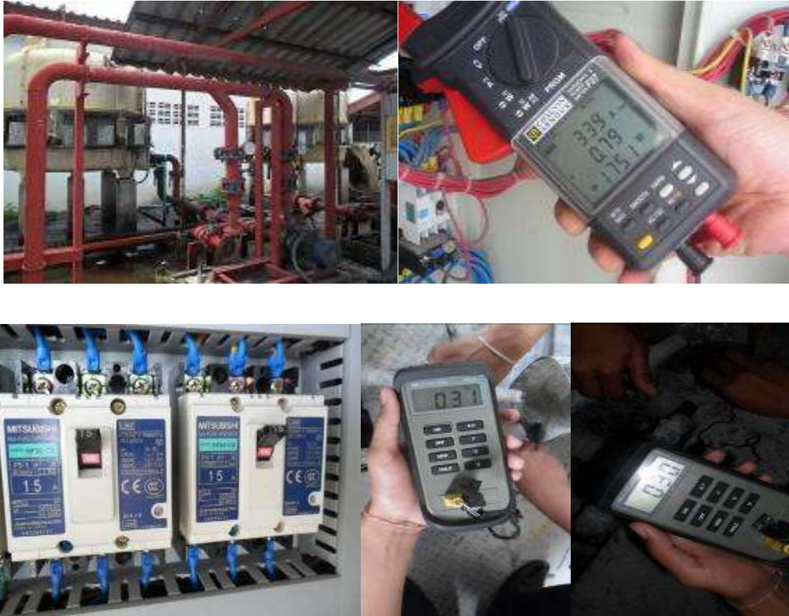
รูปแสดงการตรวจวัดพลังไฟฟ้าที่ใช้และอุณหภูมิ ก่อนปรับปรุง
