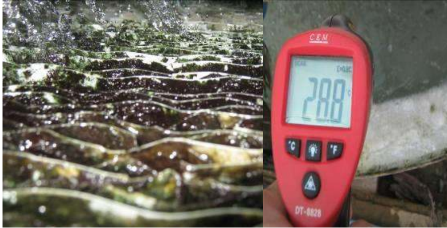
รูป Filler ของ Cooling Tower (ก่อนการปรับปรุง)
