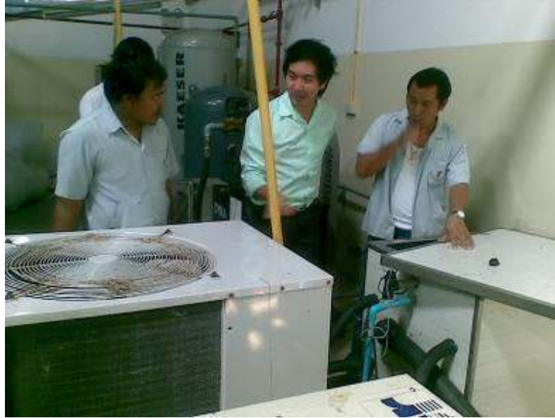
รูปแสดงเครื่องปรับอากาศตั้งอยู่ใกล้กับแผงระบายความร้อนของเครื่องทำน้ำเย็น
