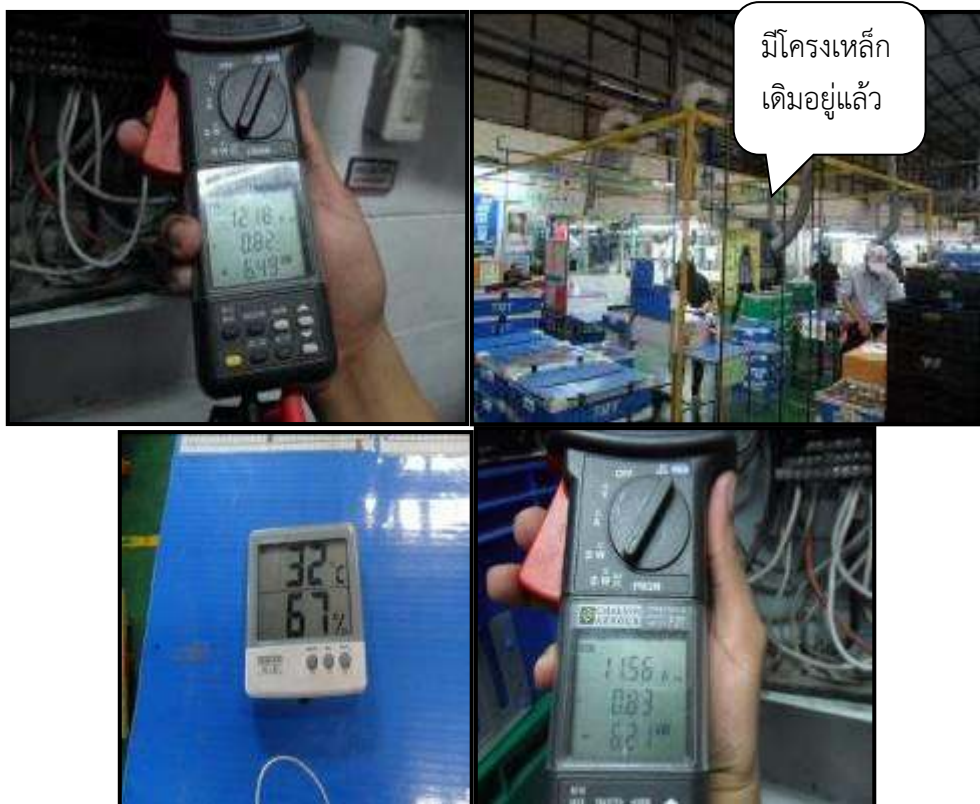
รูปแสดงพื้นที่ทำงานของเครื่องปรับอากาศและการตรวจวัด ก่อนปรับปรุง
