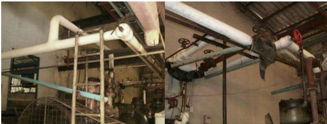
รูปแสดงท่อนำสารทำความเย็นไม่ได้หุ้มฉนวน
