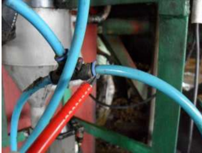
รูปแสดงจุดรั่วไหลของอากาศอัดในโรงงาน
