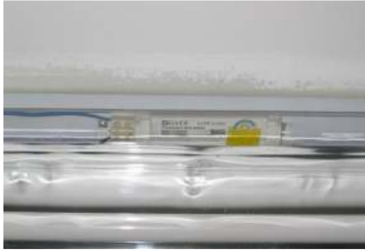
รูปบัลลาสต์โลว์ลอสที่ติดตั้งใช้งานในโรงงาน
