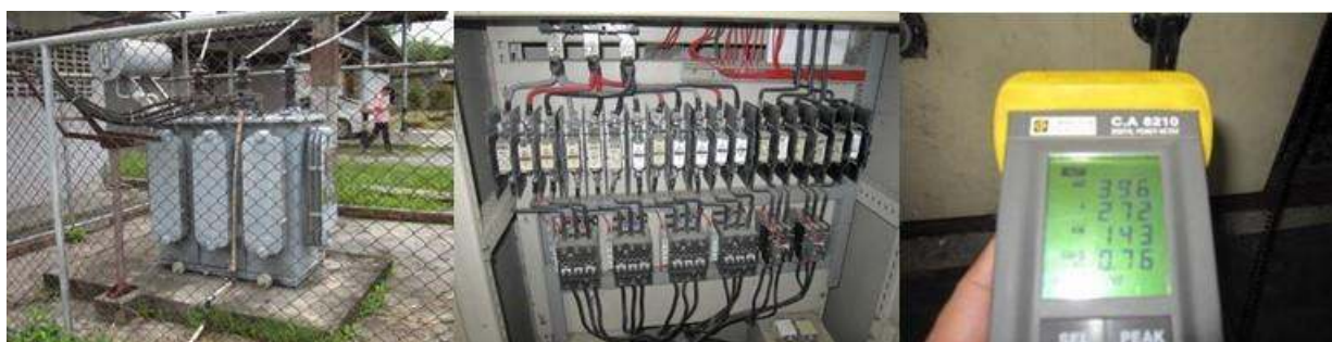
รูปแสดงหม้อแปลงไฟฟ้า ขนาด 500 kVA ชุดตัวเก็บประจุ และผลการตรวจวัดพลังงานไฟฟ้า
